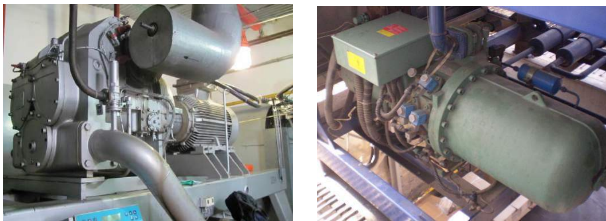
Рис. 1. Общий вид компрессорной установки с применением винтового компрессора
